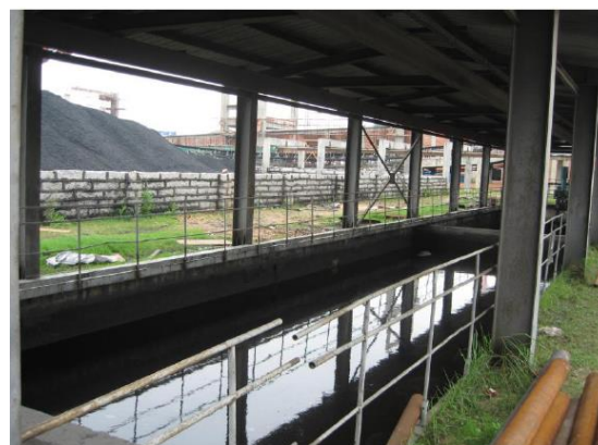
煤水处理设施
